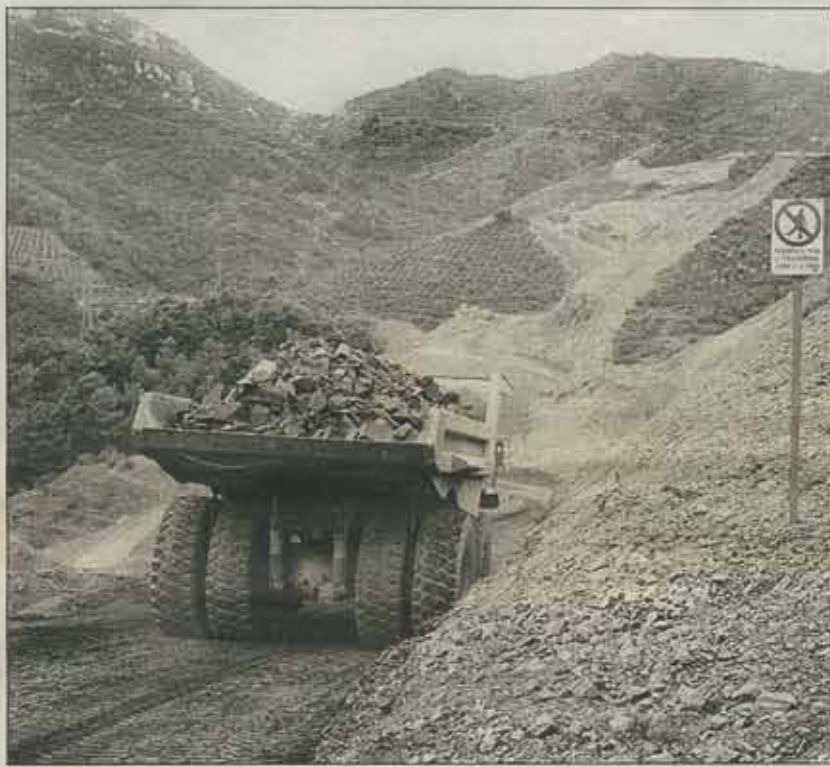
Estat que presenten les obres de remodelació de l'N-420, entre els colls Negre i de la Teixeta. Foto: M. RIERA.
